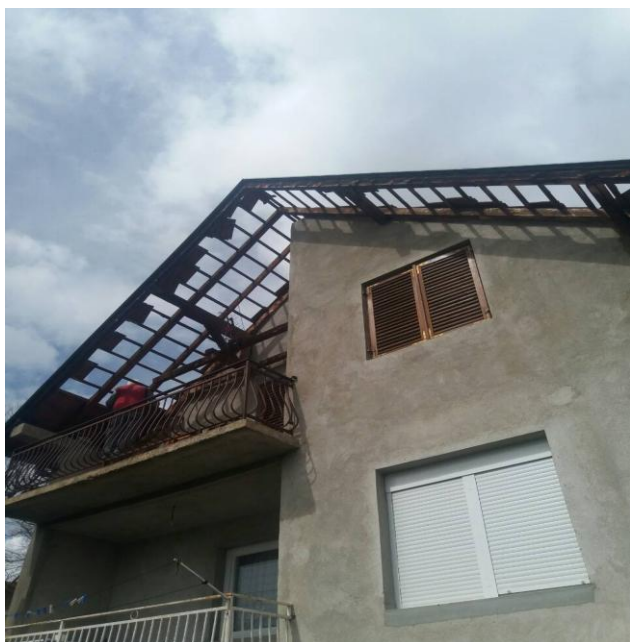
Jedna od oštećenih kuća u naselju Deževa
